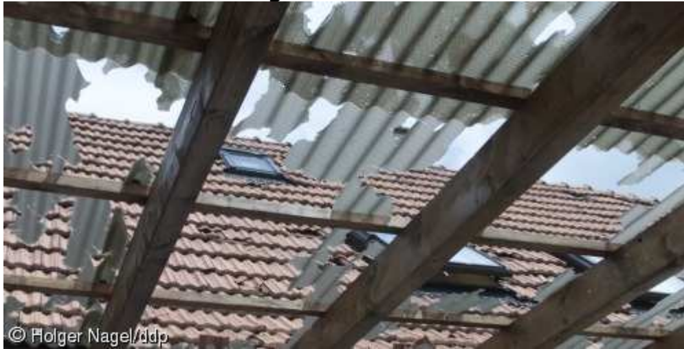
Ein vom Hagel beschädigtes Hausdach? Die richtige Versicherung hilft
